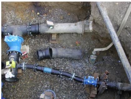
Das Wasserrohrnetz im Fokus (Bildnachweis: SWBW)
